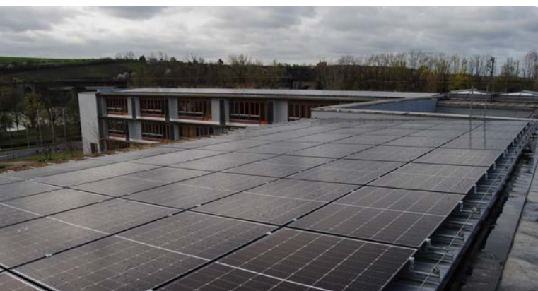
Landkreiseigene Realschule Kitzingen: PV-Anlage mit 237 kWp, Eigennutzung, 2023 (Foto: Anke Hormel)
