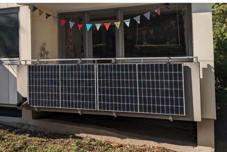
Beispiel für ein privates Balkonkraftwerk (Foto: Stadt Coburg)
