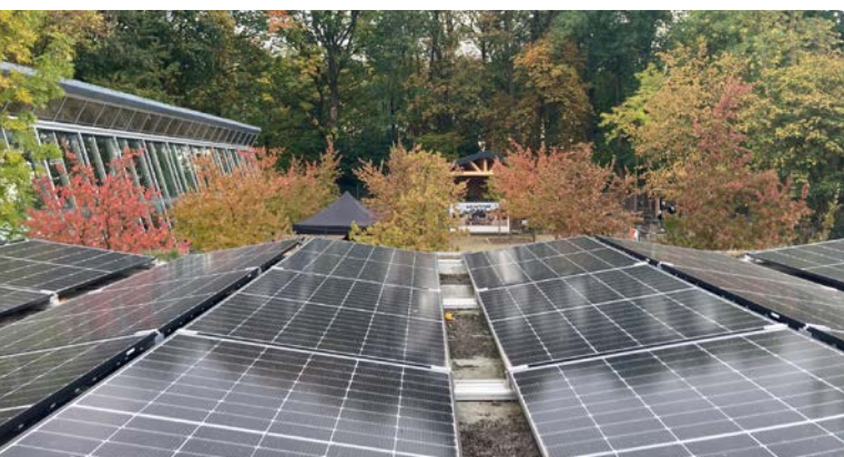
PV-Anlage auf dem Dach eines Zoogebäudes (Foto: Stadt Hof)
